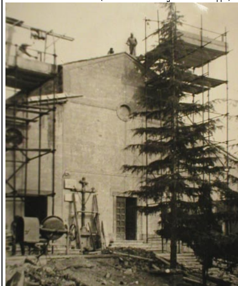
La facciata della chiesa poco dopo l'inizio dei lavori: era molto diversa da come è ora! (sul tetto Bellini Sorge e Neri Giuseppe)
